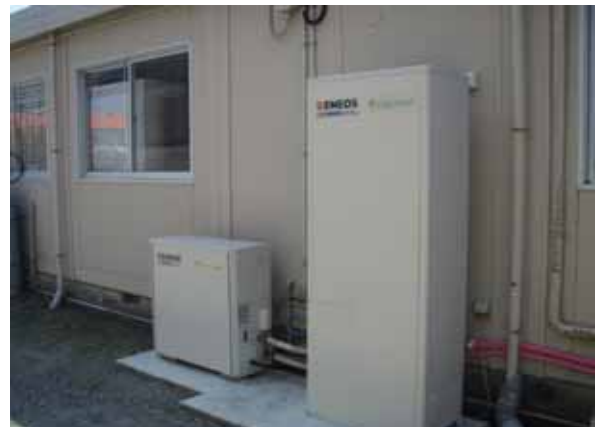
＊休憩室に残ガスを利用したエネファーム設置 (温水・電気)。
